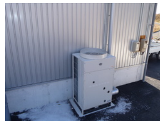
㉒室外型冷凍機
